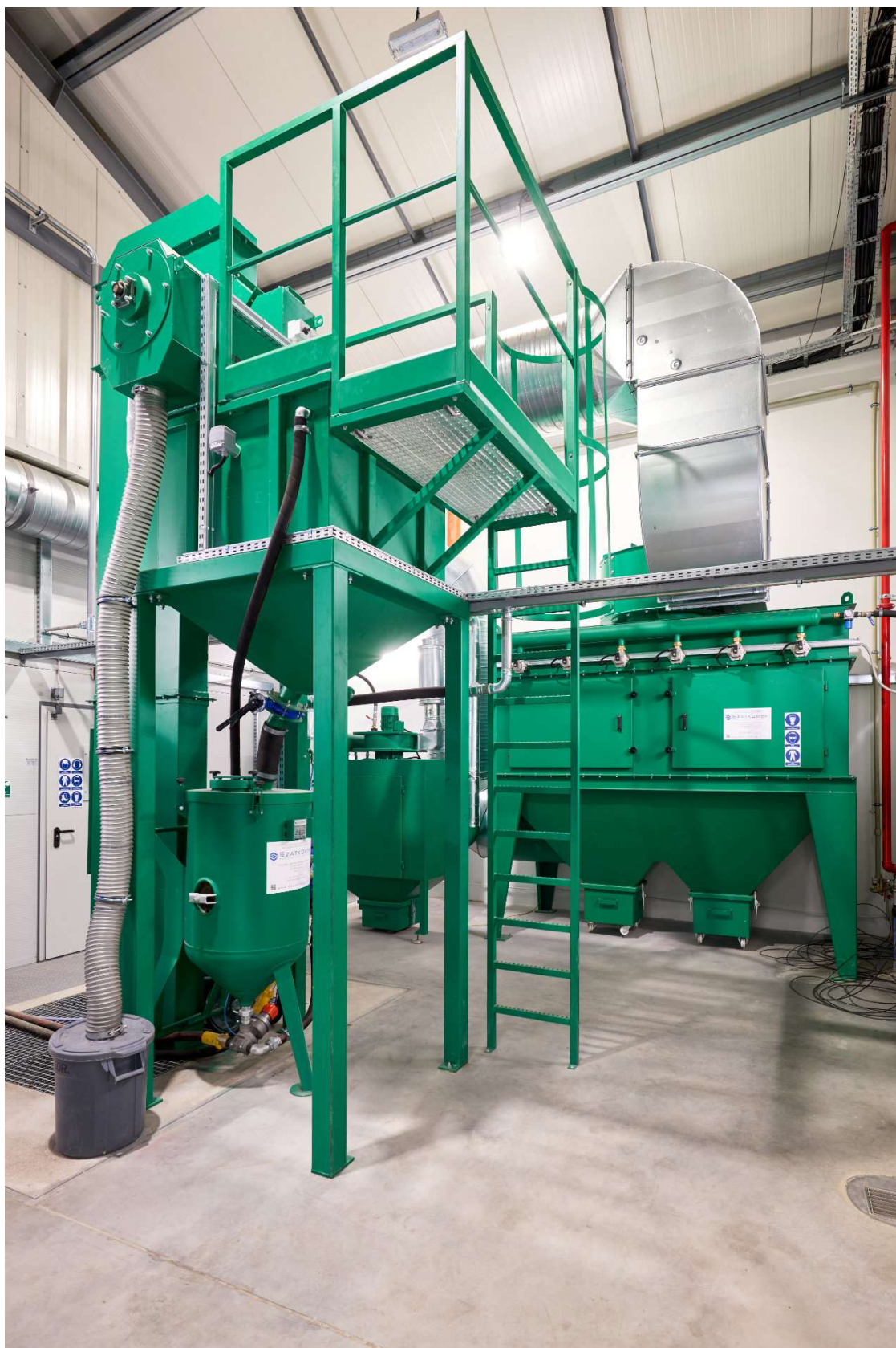
Fot. 11 Infrastruktura techniczna komory śrutowiczej
