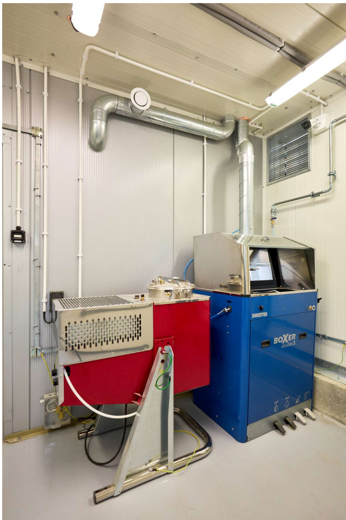
Fot. 12 Urządzenia techniczne komory lakierniczej
