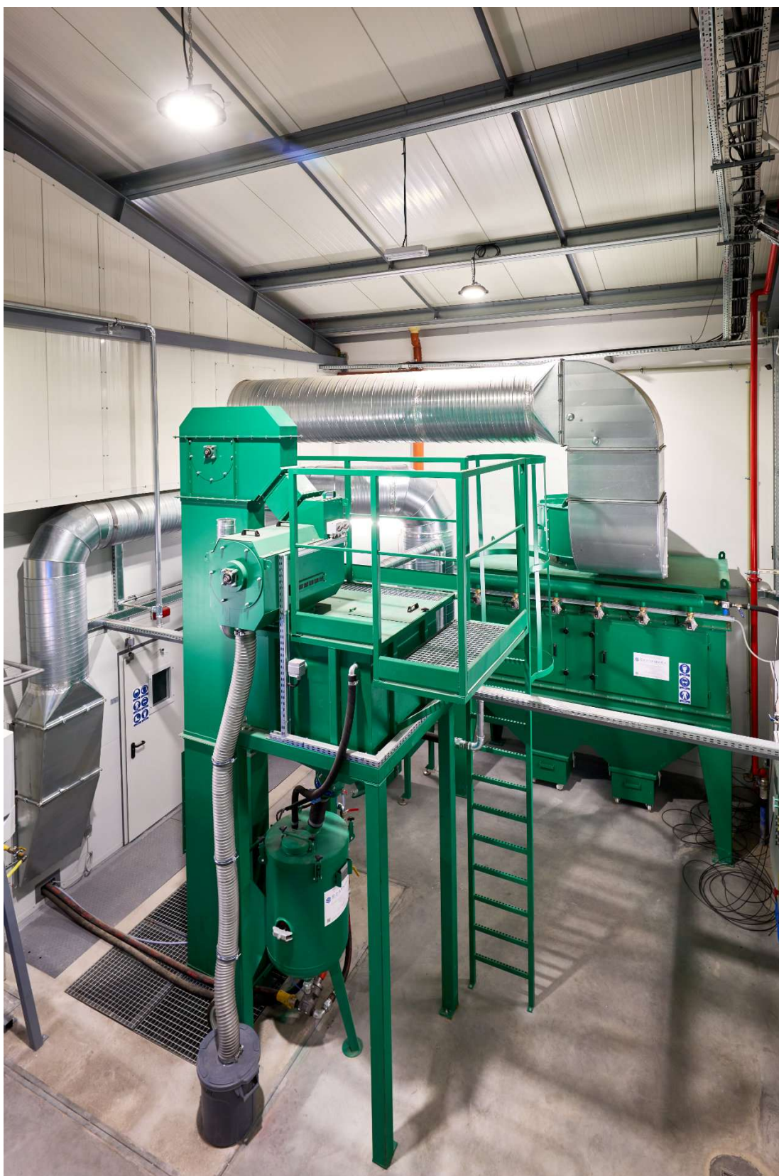
Fot. 14 Infrastruktura techniczna komory śrutowniczej
